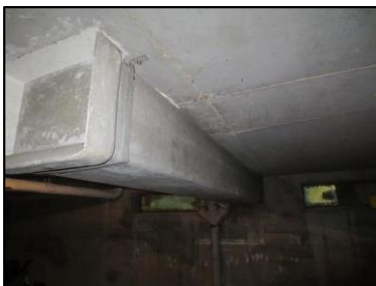
Photo N° 880 AMIANTE CIMENT -- DEGAGEMENT -1 Gaines & coffres horizontaux Ventilation haute (Fibres-ciment)
